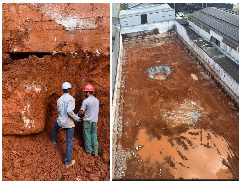
Imagens 05 e 06 – Bloco inesperado durante a escavação e situação da vizinhança no início da escavação
