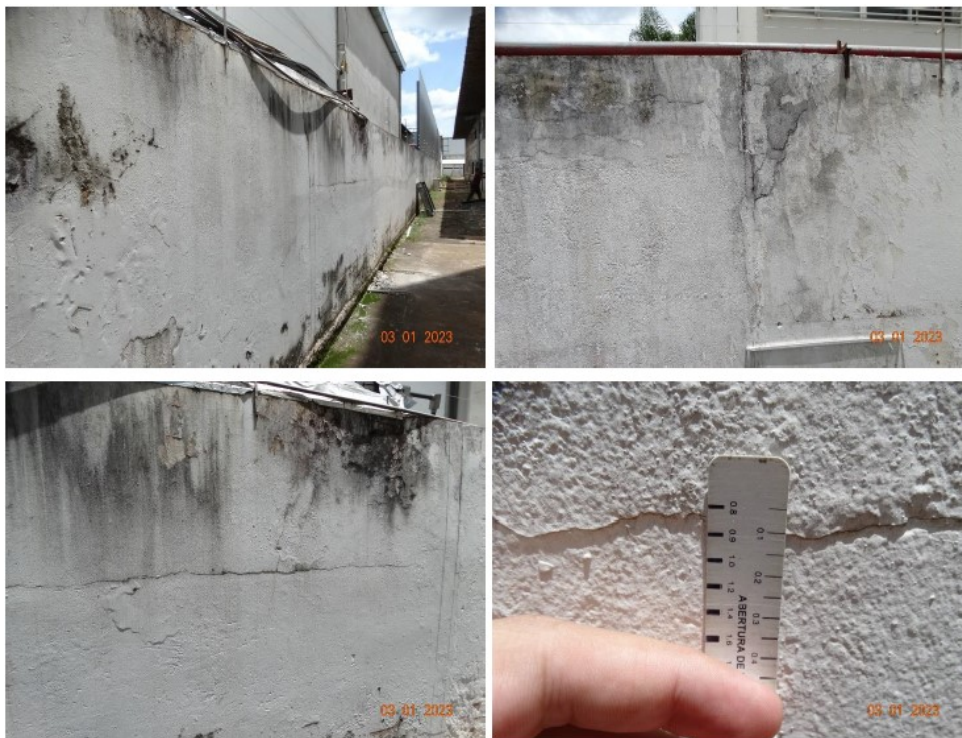
Imagens 01 a 04 – Situações dos muros de divisa entre CFMV e vizinhança, observado em Laudo de Vizinhança
