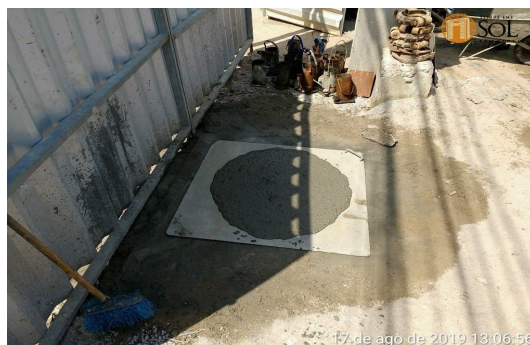
Flow fora das especificações – diâmetro acima de 750mm
