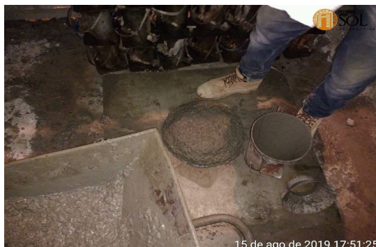
Flow fora das especificações – diâmetro abaixo de 650mm
